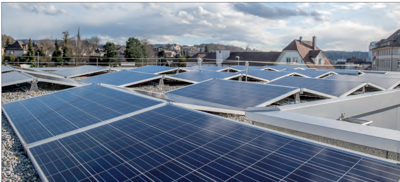
In Herzogenbuchsee stellt die EWK die Stromversorgung sicher – und sie produziert auch selber Strom mit eigenen Solaranlagen (Bild: mwh)
